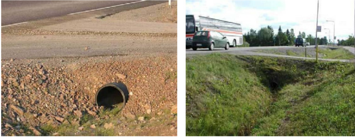
Şekil 55: Tehlikeli drenaj yapısı örnekleri (Kaynak: [A.2])
